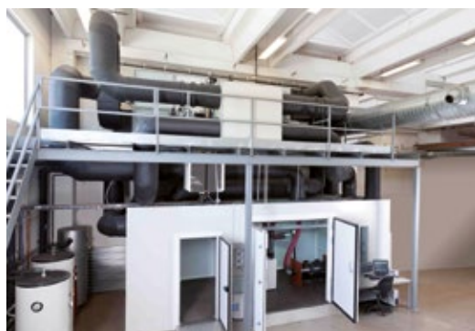
Klimatická komora pro testování rekuperačních jednotek
