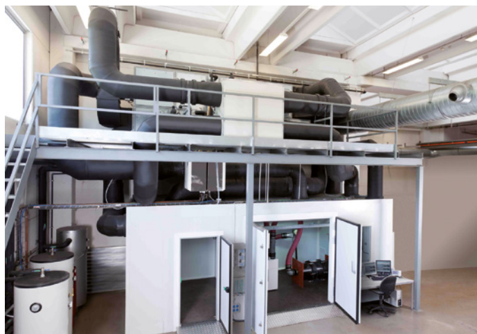
Klimatická komora pro testování rekuperačních jednotek
